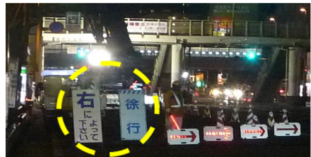
b) 看板設置状況
